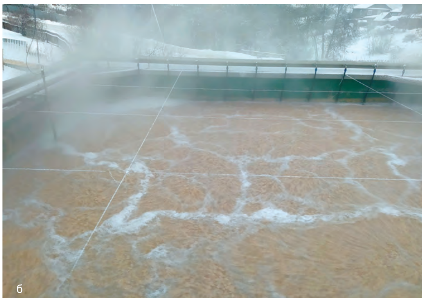
MBBR на очистных сооружениях предприятия по производству сыра: а) в процессе загрузки носителей; б) после обрастания биопленкой и полного погружения
